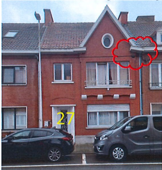
Schadebeeld 003 – rechter gedeelte dakgoot lekt
