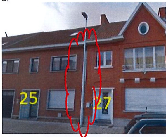
Schadebeeld 007 – Ernstige vochtaftekening aan de buitenmuren van woning 25 en woning 27
