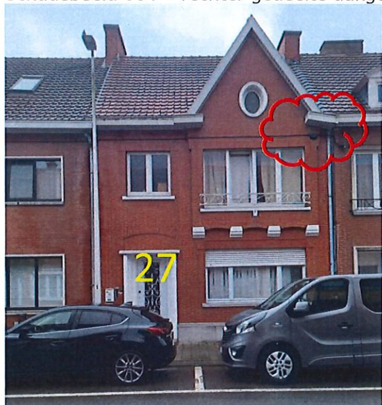
Schadebeeld 004 – rechter gedeelte dakgoot loopt over
