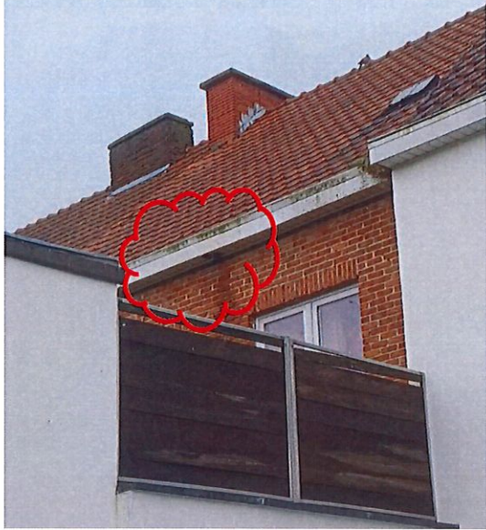
Schadebeeld 011 – RWA-afvoer ontbreekt
