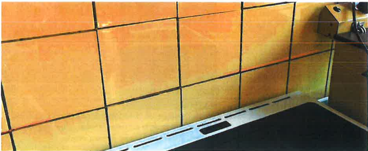
Laser de niveau : évolution du tassement le long du pignon, à comparer au joint de carrelage
