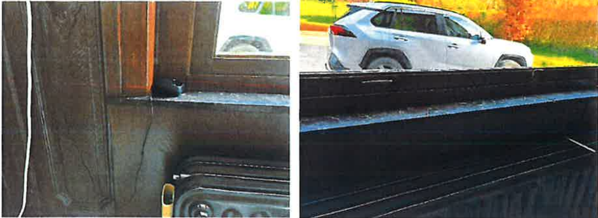
Laser de niveau : évolution du tassement le long de la façade arrière à comparer au seuil
