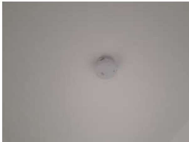
Détection incendie dans chaque appartement
