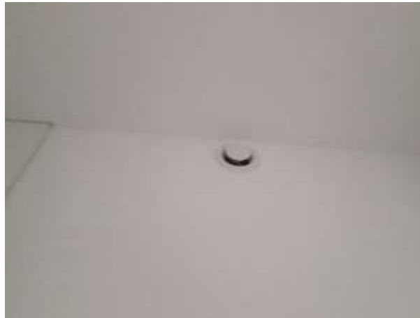
Système d'extraction mécanique des salles de bain.
