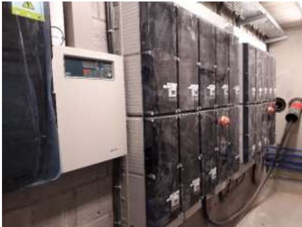
Compteur électrique à la cave
