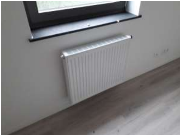
Radiateurs à vanne thermostatiques
