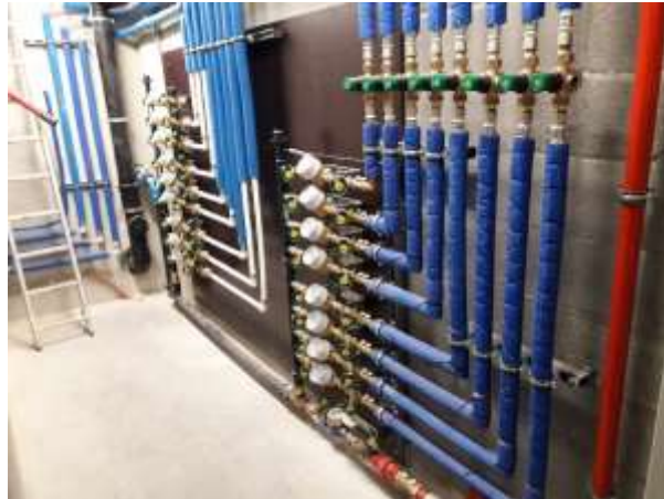
Compteur d'eau pour le bloc A et B situé au -1 sous le bloc A
