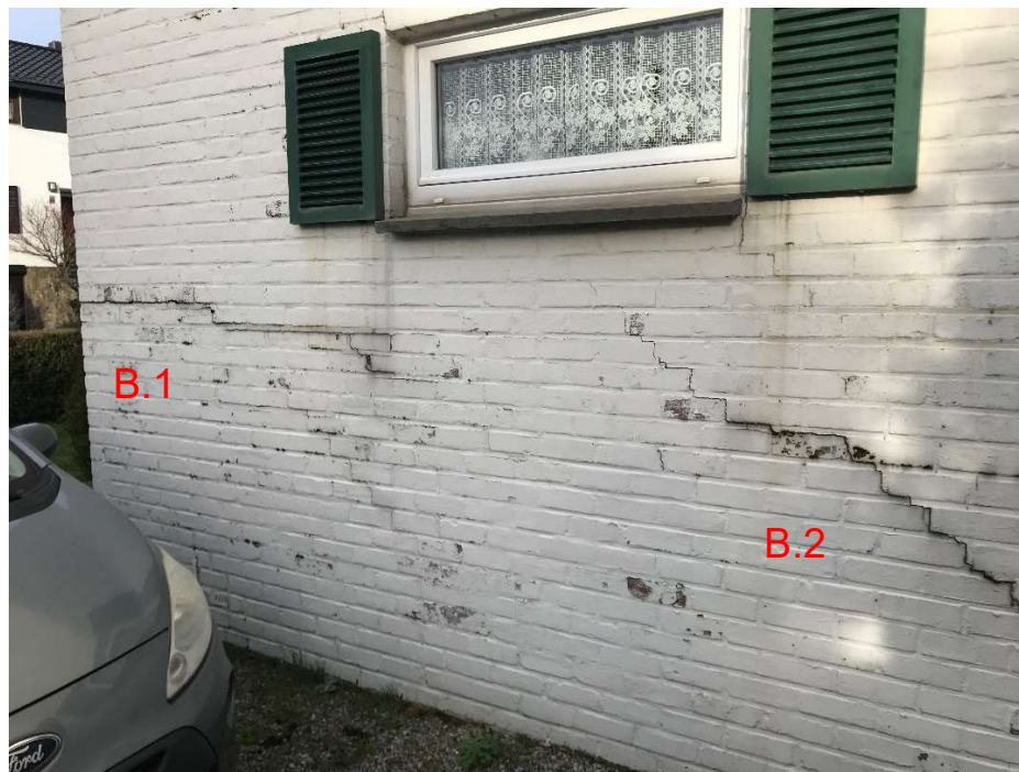
Figure 5 : Fissures B.1 et B.2
