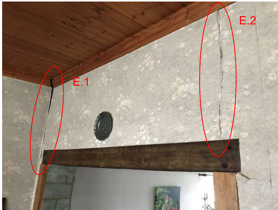
Figure 17 : Fissures E.1 et E.2
