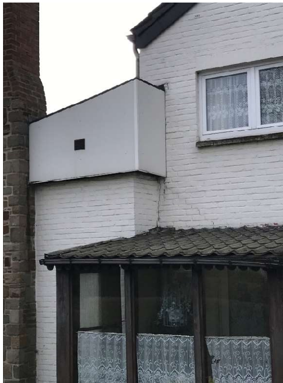
Figure 8 : Façade latérale gauche / Fissure C.1
