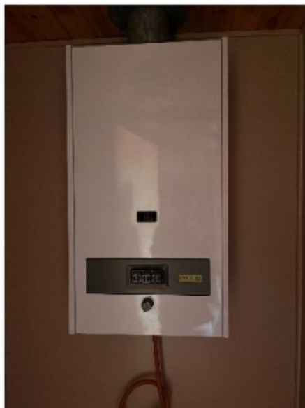
chauffe-eau gaz salle de bains
