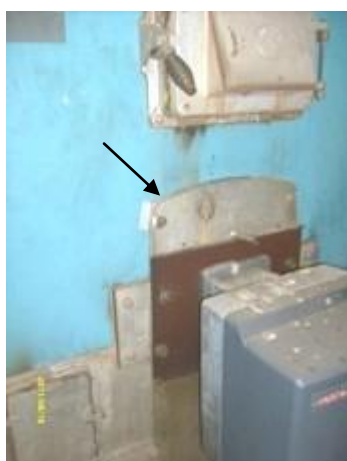
Photo 45 (joint de chaudière)
