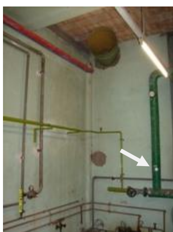
Photo 25 (calorifuge – local chaufferie)
