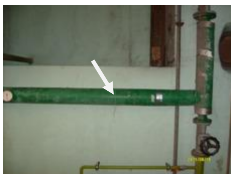
Photo 21 (calorifuge – local chaufferie)
