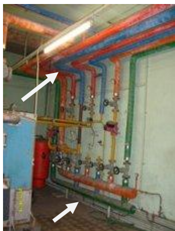
Photo 23 (calorifuge – local chaufferie)
