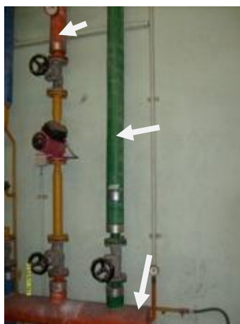
Photo 20 (calorifuge – local chaufferie)
