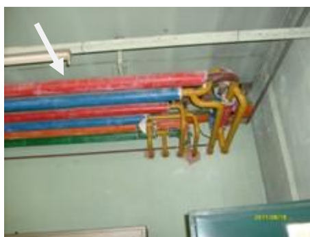
Photo 22 (calorifuge – local chaufferie)
