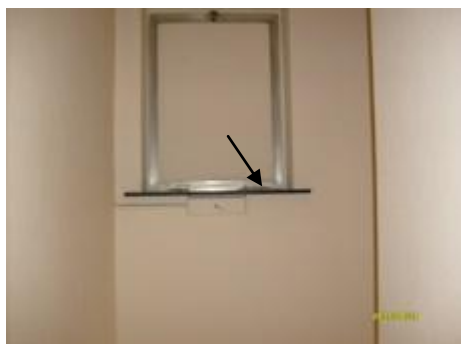
Photo 41 (tab. de fen. – cage d'escalier centrale)
