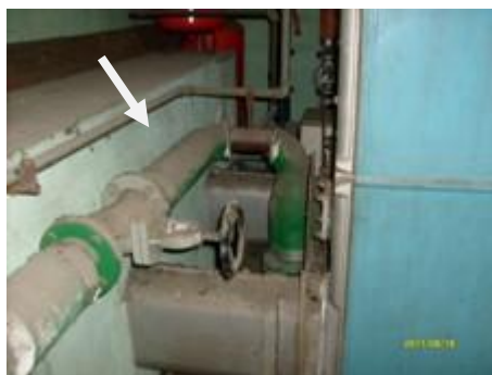
Photo 24 (calorifuge – local chaufferie)
