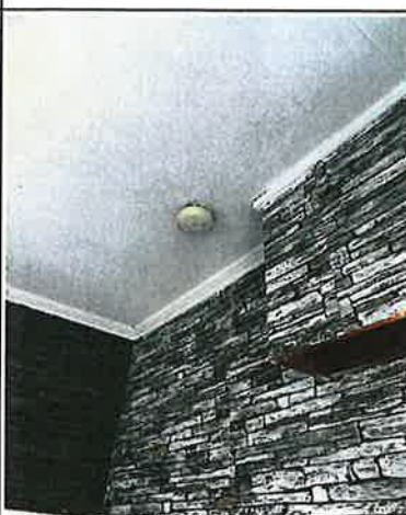
Foto 5: 82: het gebouw voldoet niet aan de rookmeldersverplichting
