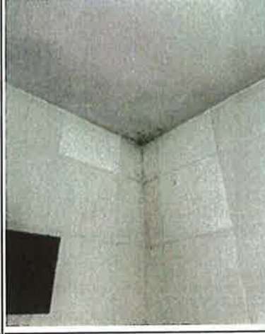
Foto 9: 102: VOCHTSCHADE: condenserend vocht met schimmelvorming
