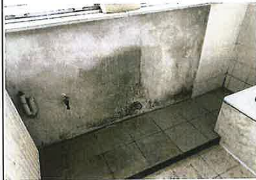
Foto 11: 113: AFWERKING van de buitenmuren: beschadiging (excl. vochtschade) of verwerking / noodzakelijke afwerking ontbreekt
