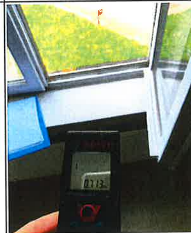
Foto 13: 171: trappen, overlopen, borstweringen met gebruiksonveilige elementen ( te steil / gebreken ...) / trap naar een woonfunctie ontbreekt
