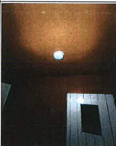
Foto 4: 82: het gebouw voldoet niet aan de rookmeldersverplichting
