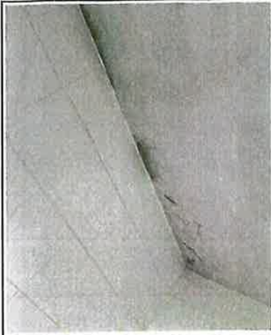
Foto 8: 102: VOCHTSCHADE: condenserend vocht met schimmelvorming
