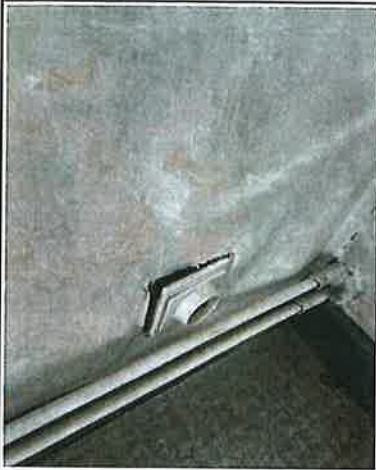
Foto 16: 195: indicatie van een risico op elektrocutie
