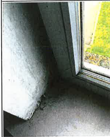
Foto 10: 112: VOCHTSCHADE: condenserend vocht met schimmelvorming
