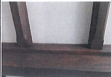
Foto 17: 102: condenserend vocht met schimmelvorming Condenserend vocht met schimmelvorming in leefruimte
