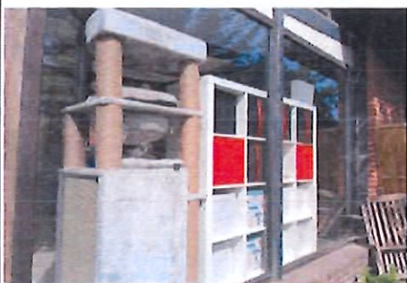
Foto 4: 21: vervorming en/of scheurvorming van gevelvlak of gevelelementen
