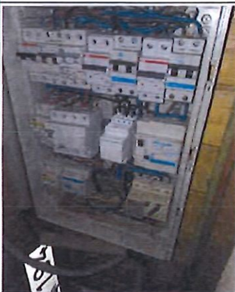
Foto 6: 51: indicatie van een risico op elektrocutie/brand
