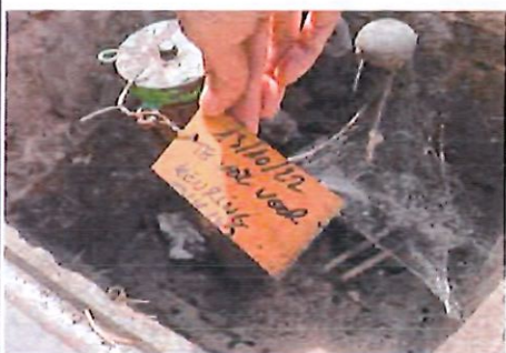
Foto 14: 61: indicatie van een risico op ontploffing/brand Geen geldige keuring stookolietank
