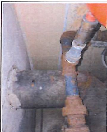
Foto 34: 227: indicatie van een risico op CO-vergiftiging Niet aansluitende en luchtdicht aansluitkanaal stookolieketel + niet afgesloten injectieopening
