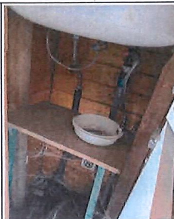
Foto 9: 51: indicatie van een risico op elektrocutie/brand Warmwaterboiler met aanraakbare bedrading onder spanning
