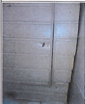
Foto 20: 103: beschadiging (excl. vochtschade) of verwerking / noodzakelijke afwerking ontbreekt Verzakt zolderluik
