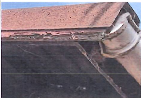
Foto 2: 11: aantasting en /of doorbuiging van de dragende dakelementen / buitendakse schouw onstabiel / ...
