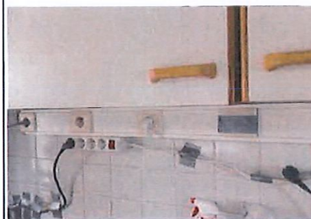
Foto 11: 51: indicatie van een risico op elektrocutie/brand Verdeelstekker in gebruik als vaste onderdeel van de elektrische installatie
