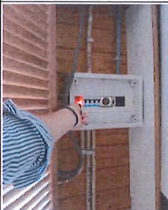
Foto 7: 51: indicatie van een risico op elektrocutie/brand
