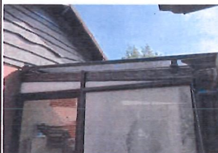
Foto 5: 21: vervorming en/of scheurvorming van gevelvlak of gevelelementen
