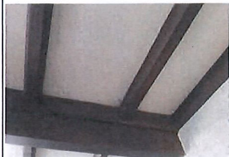
Foto 16: 102: condenserend vocht met schimmelvorming Condenserend vocht met schimmelvorming in leefruimte
