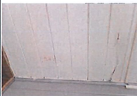
Foto 19: 102: condenserend vocht met schimmelvorming Condenserend vocht met schimmelvorming in keuken
