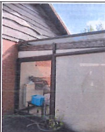
Foto 3: 11: aantasting en /of doorbuiging van de dragende dakelementen / buitendakse schouw onstabiel / ...
