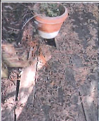
Foto 36: 232: de woning is niet veilig toegankelijk (bv. gebreken aan gemeenschappelijke gangen, trappen...) Ontbrekende, losliggende, rotte planken terras
