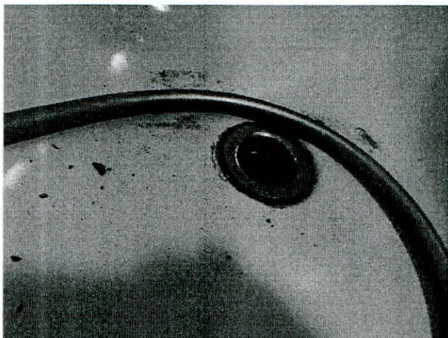
Afb12: De sifon van het bad zit los. Bij gebruik van het bad treedt waterverlies op, wat lokaal vochtophoping en vochtschade veroorzaakt.
