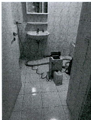
Afb14 Alle afvoeren worden getest met rookgas. Er wordt nergens rookgas waargenomen.
