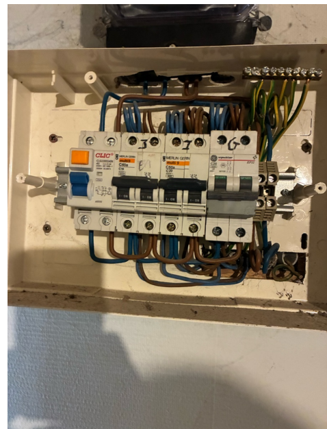
( Elektrisch bord - binnenkant )
