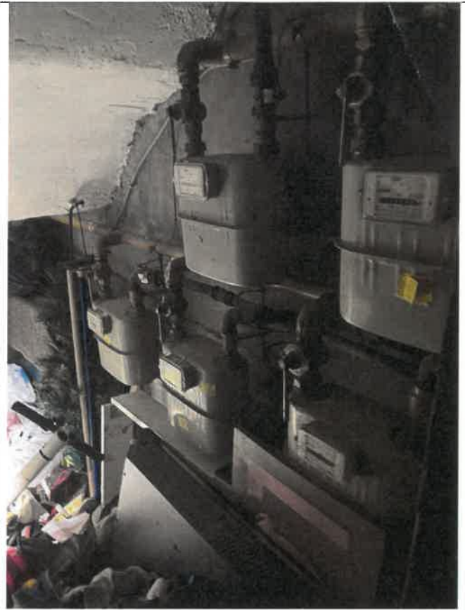
Photo 19 - Compteurs de gaz
