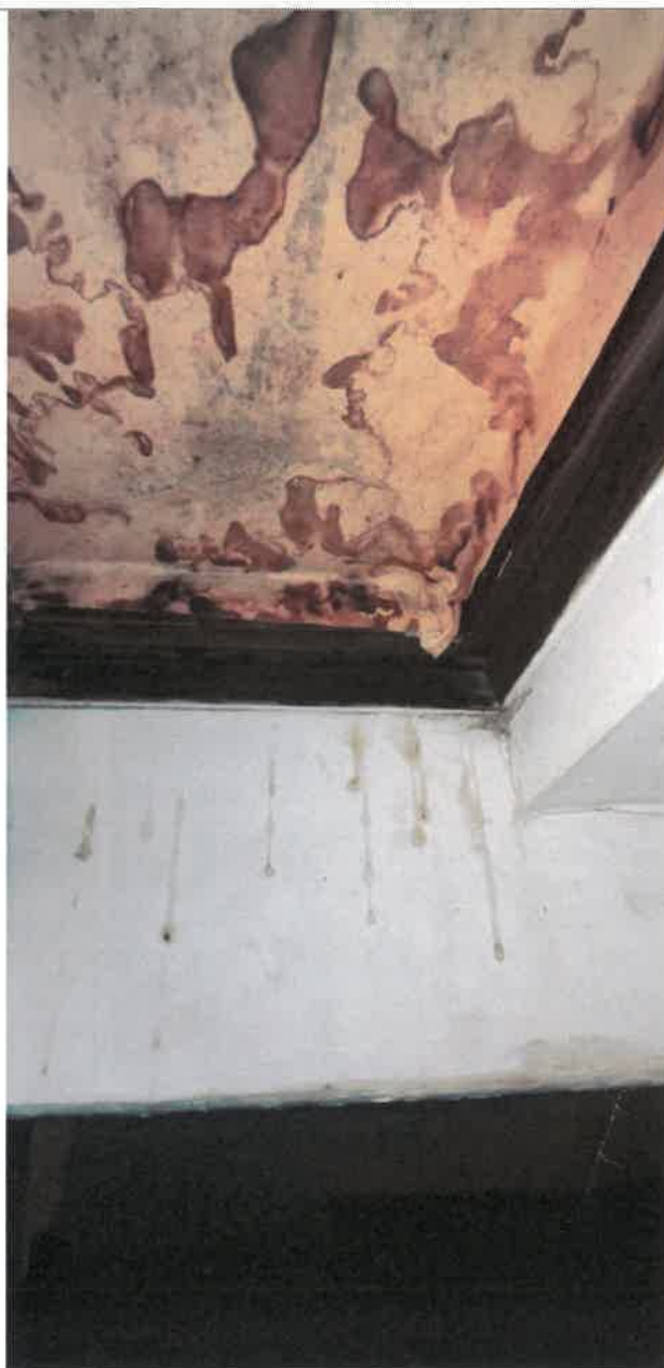
Photo 93 - Vue de la fenêtre de toit vétuste.
