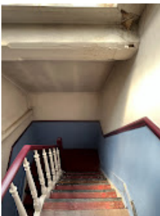
Dégats interieur du toiture2.HEIC 1373K
