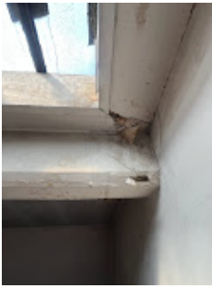
Dégats interieur du toiture.HEIC 1523K
