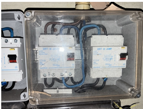
( Elektrisch bord - binnenkant )
