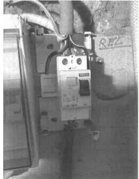
( Tableau électrique - intérieur )
