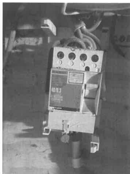
( Tableau électrique - intérieur )
