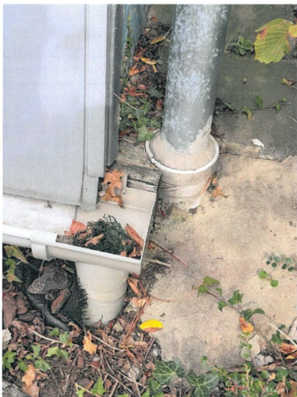
Evacuation DEP bouchée (coint avant droit)
