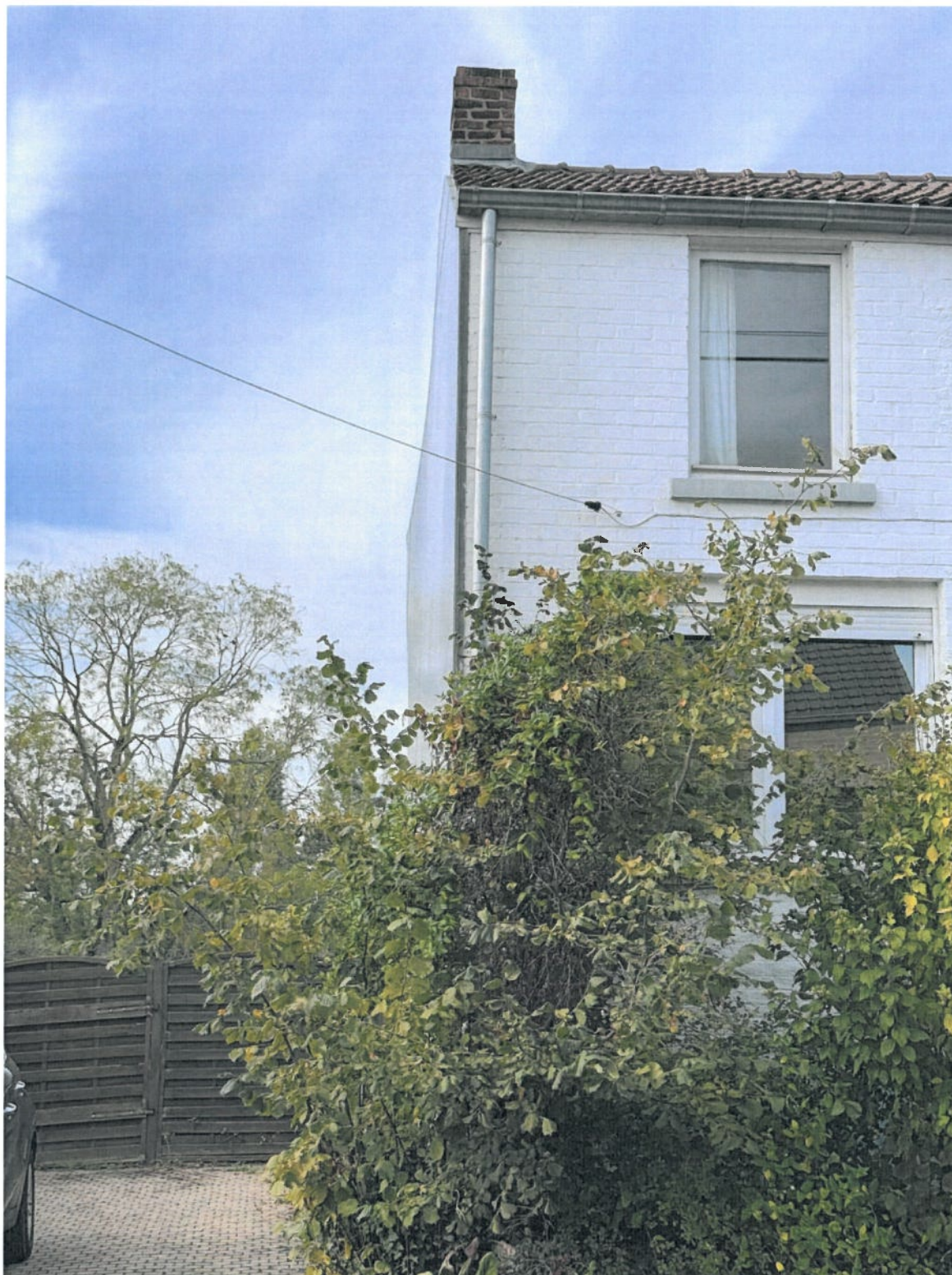
Déformation hors plan de la façade pignon
