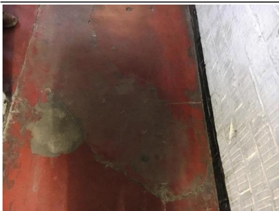
Vloer niet egaal gegoten (mogelijk werken)
