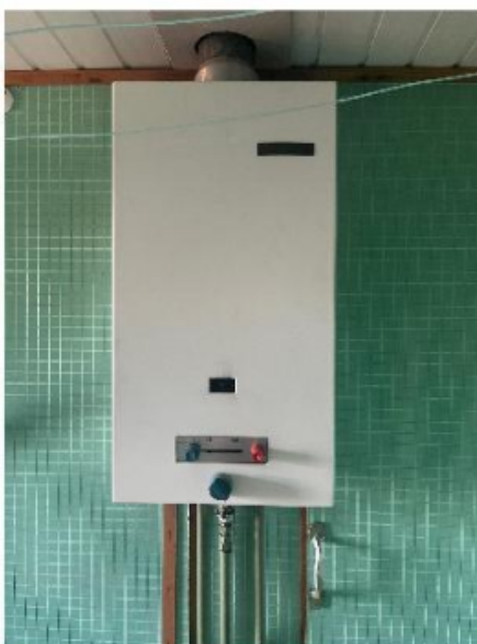
chauffe-eau gaz sdb étage
