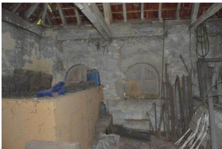
Algemene zichten, respectievelijk richting zuidzijde, noordzijde en oostzijde (tuinzijde). Muren bepleisterd en geschilderd, algemene verwerde toestand. De vloeren of afdekking van de gewelven bestaan uit bakstenen.
