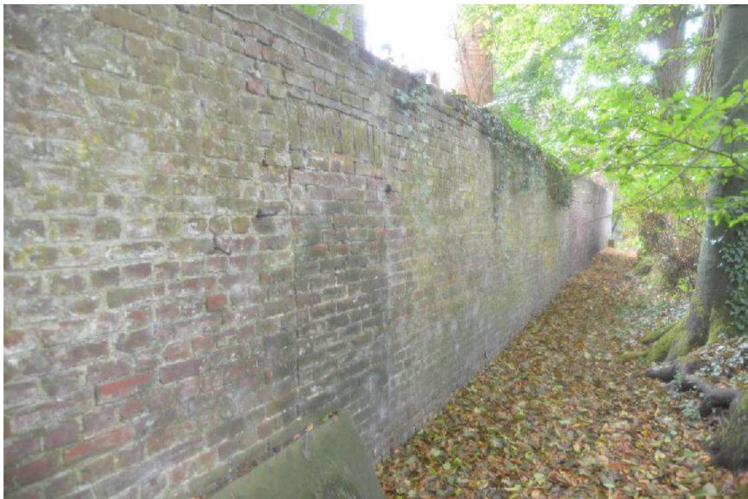
Foto links westzijde kant fabriek. Hier is de muur afgedekt met pannen. Een deel ervan is reeds verdwenen.
