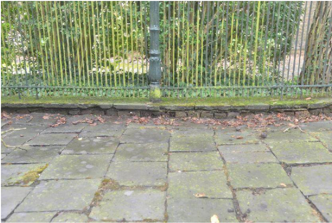
De kennel is verhard met natuursteenschorren. De randen onder het hekken waren voorheen voorzien van een rollaag in bakstenen en later afgedekt met betondallen, zie foto. Verweerde toestand.
