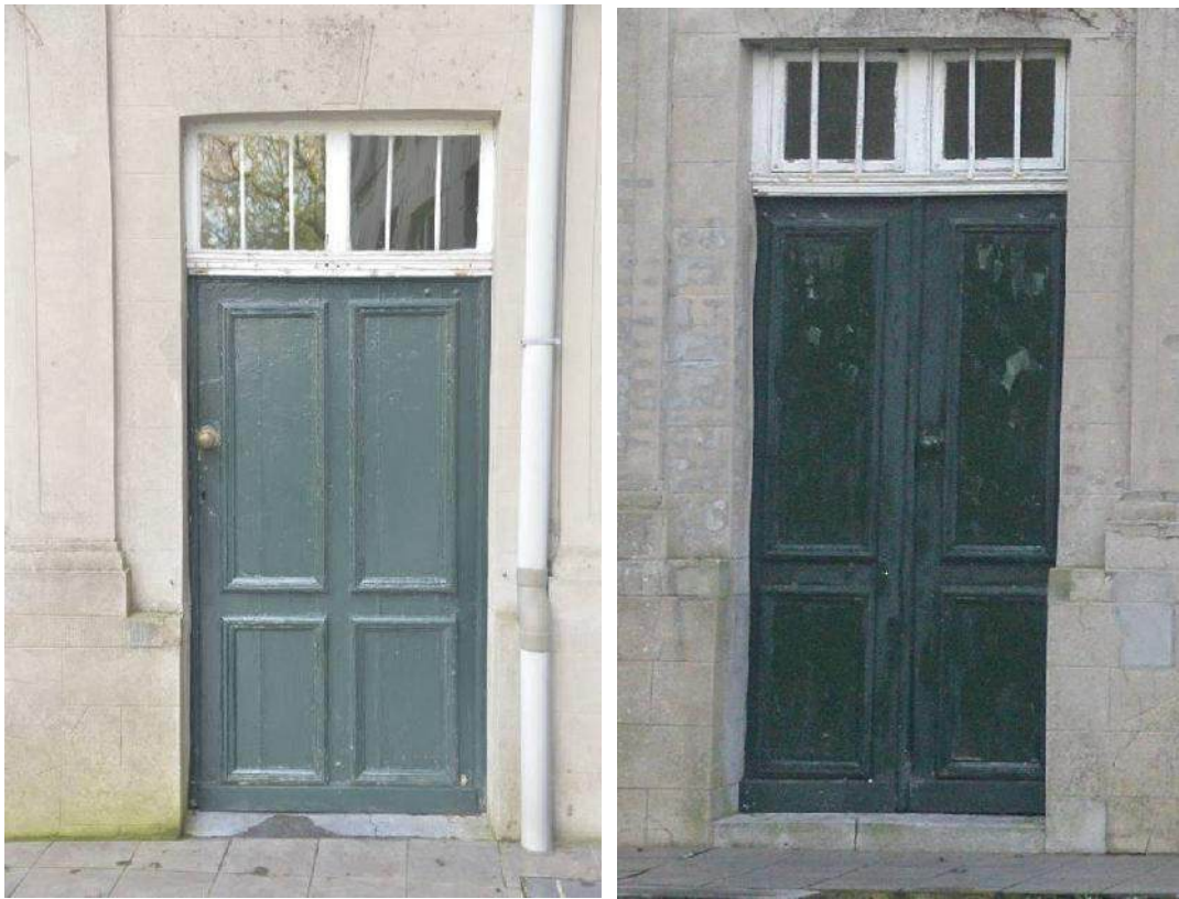
Drie klampdeuren met verticaal paneelwerk, groen geschilderd. Gedeeld wit geschilderd bovenlicht met diefijzers. De linkerdeur van de toiletruimte (foto rechts) bestaat uit twee delen. Algemene behoorlijke staat, schraal verfwerk.
