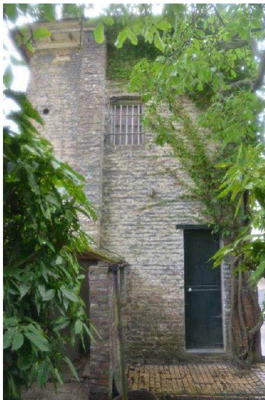
Smalle retourgevel aan de noordzijde. Deze gevel is niet bezet, we zien restanten van het oude schilderwerk, verweerde toestand. We zien ook herstel van voegwerk met cement. Smalle toegevoegde schouw.
