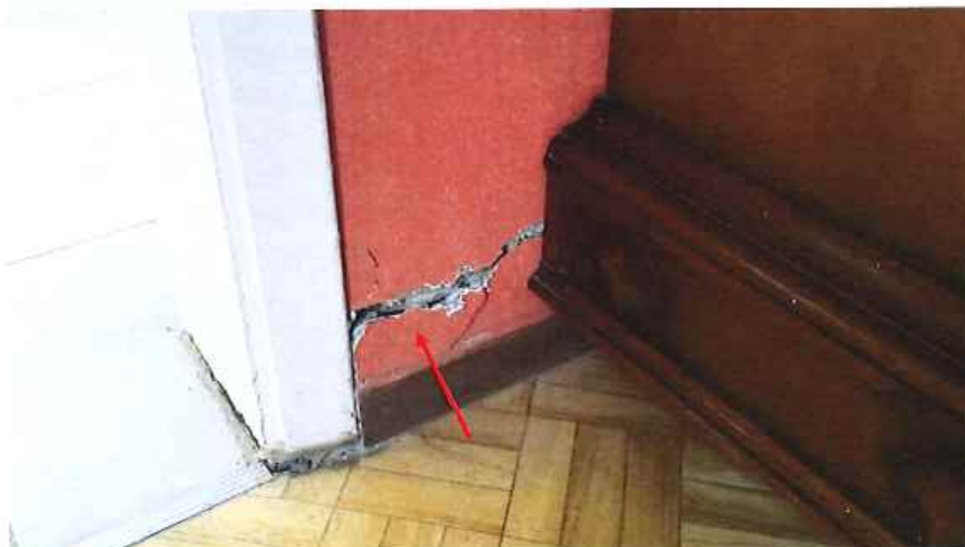
Figuur 27 : Schadebeeld n° 12 : verzakking van achtergevel / vloer, scheurvorming in ruwbouwmetselwerk en binnenpleisterwerk
