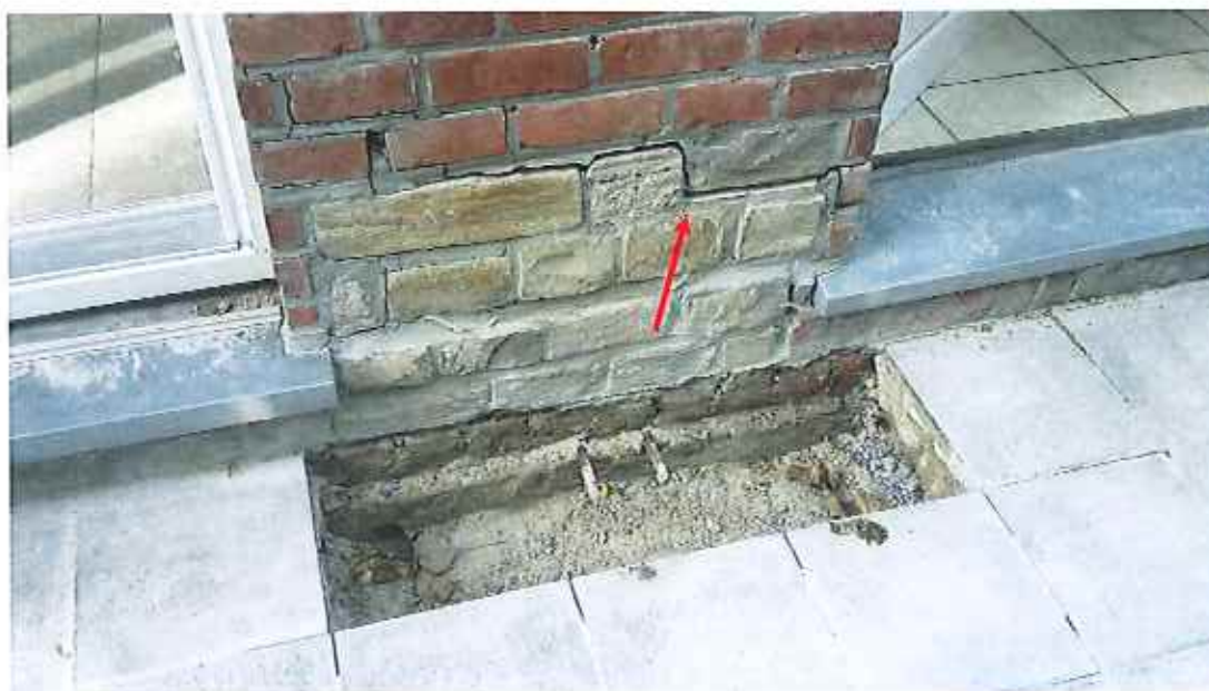
Figuur 15 : Schadebeeld n° 6 : scheurvorming in gevelmetselwerk
