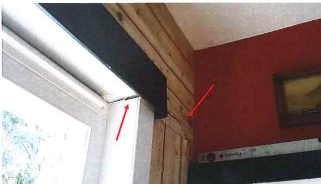
Figuur 29 : Schadebeeld n° 12 : verzakking van achtergevel / vloer, scheurvorming in ruwbouwmetselwerk en binnenpleisterwerk
