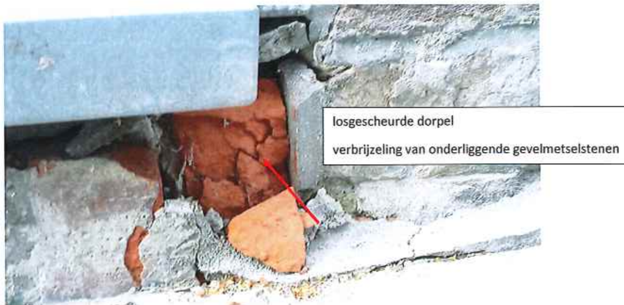
Figuur 10 : Schadebeeld n° 2 : verzakking van deurdorpel (detail 3)
