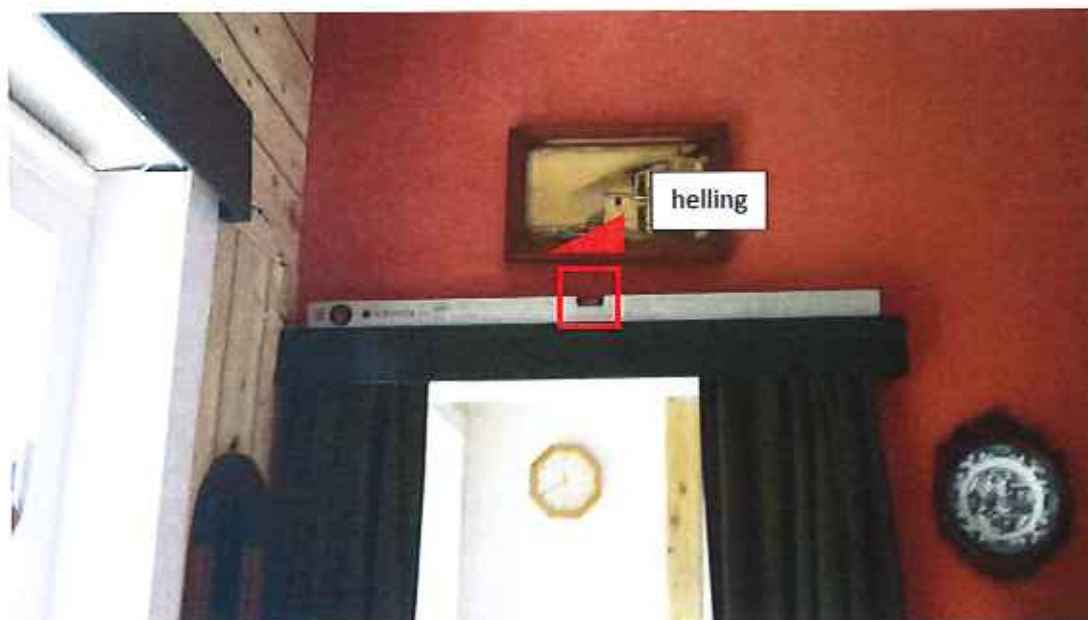
Figuur 28 : Schadebeeld n° 12 : verzakking van achtergevel / vloer, scheurvorming in ruwbouwmetselwerk en binnenpleisterwerk
