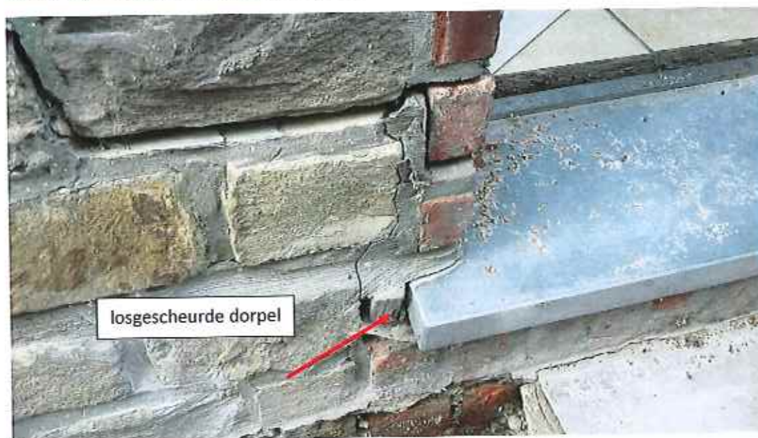
Figuur 7 : Schadebeeld n° 2 : verzakking van deurdorpel (detail 1)
