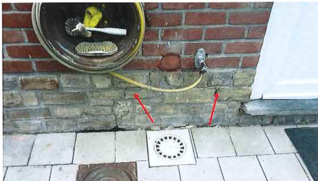
Figuur 22 : Schadebeeld n° 10 : lichte scheurvorming in gevelmetselwerk
