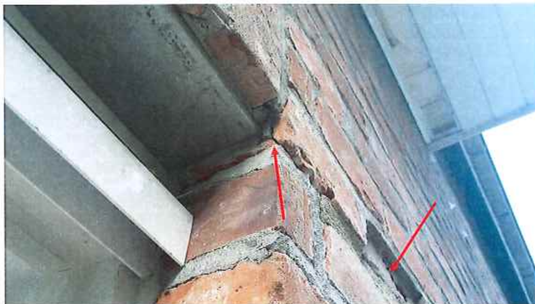
Figuur 14 : Schadebeeld n° 5 : scheurvorming in gevelmetselwerk en afbrokkeling van gevelmetselwerk (detail)
