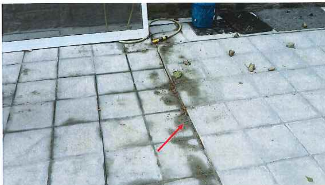
Figuur 12 : Schadebeeld n° 4 : verzakking van terras
