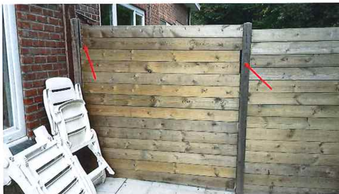
Figuur 11 : Schadebeeld n° 3 : differentiële beweging tussen palen van tuinafsluiting
