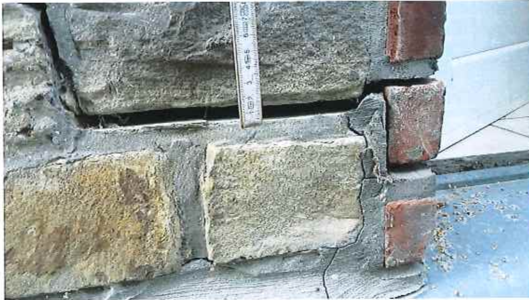
Figuur 16 : Schadebeeld n° 6 : scheurvorming in gevelmetselwerk (detail)
