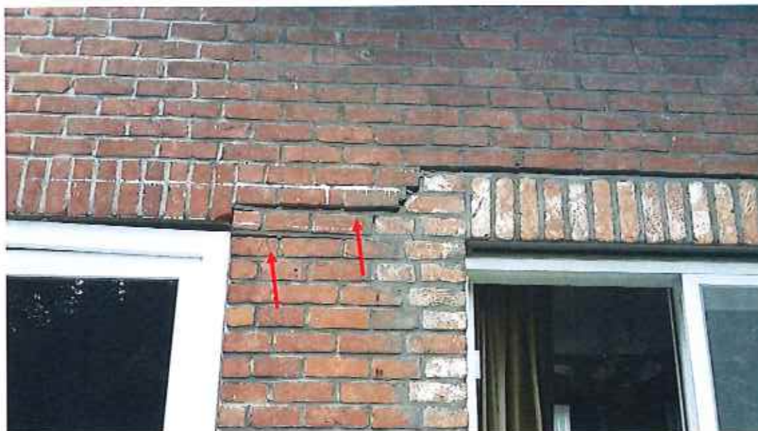
Figuur 23 : Schadebeeld n° 11 : scheurvorming in gevelmetselwerk
