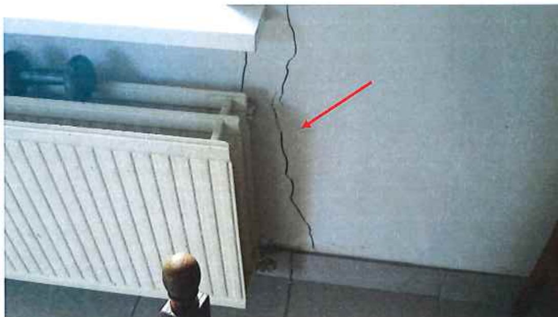
Figuur 20 : Schadbeeld n° 8 : scheurvorming in binnenpleisterwerk
