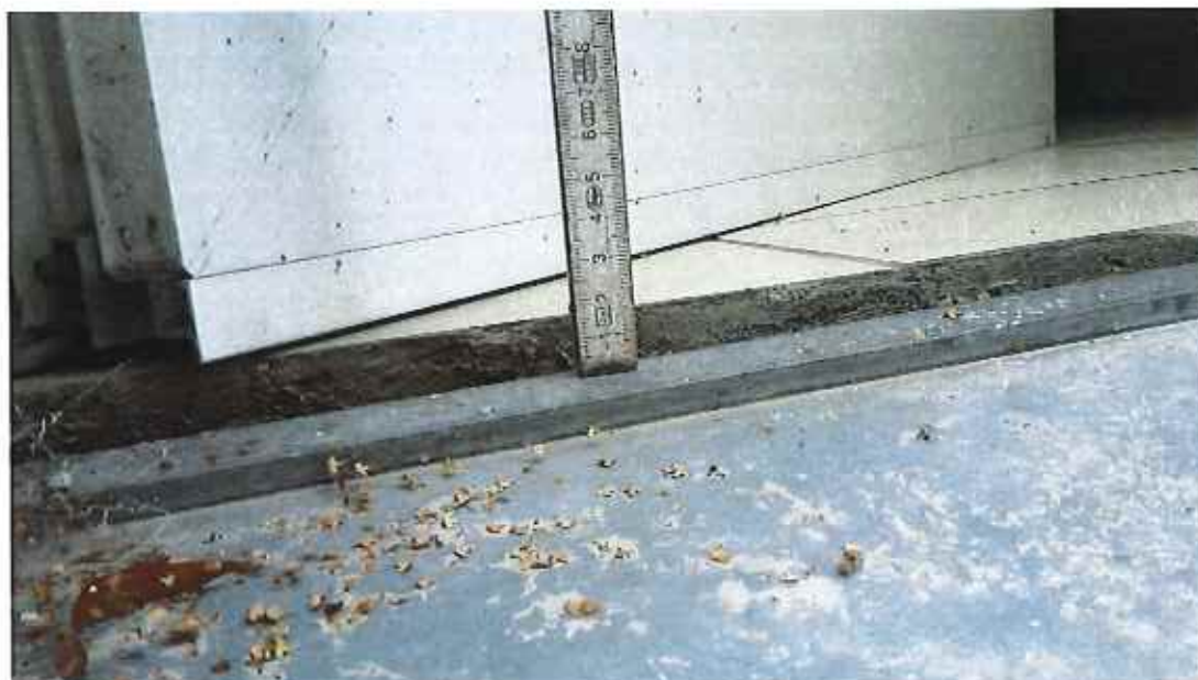
Figuur 8 : Schadebeeld n° 2 : verzakking van deurdorpel (detail 2)
