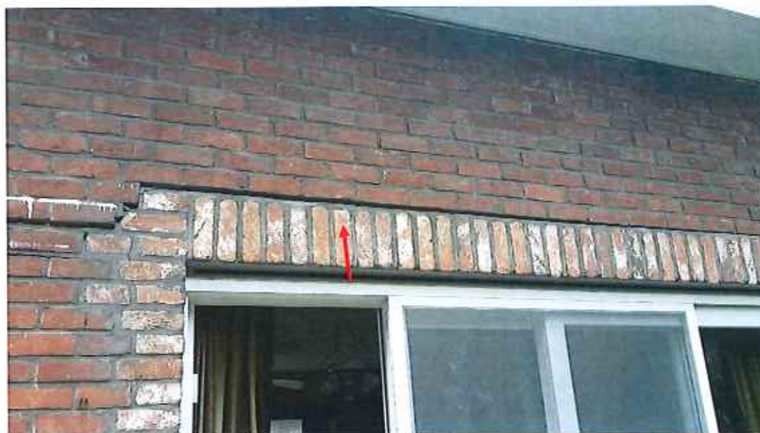
Figuur 24 : Schadebeeld n° 11 : scheurvorming in gevelmetselwerk
