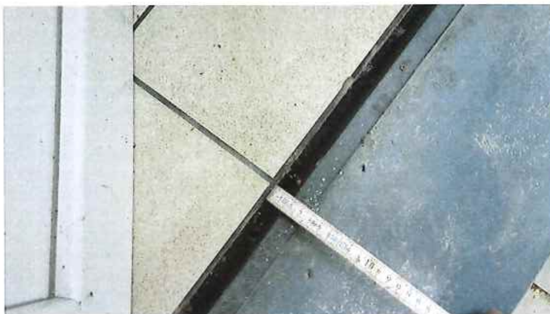
Figuur 9 : Schadebeeld n° 2 : verzakking van deurdorpel (detail 2)
