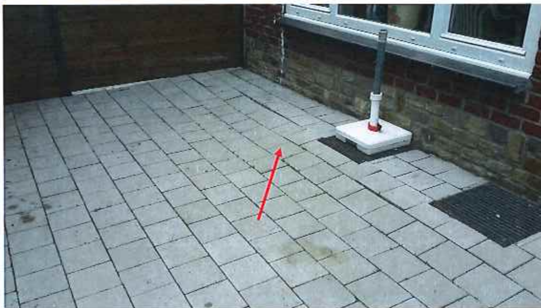
Figuur 21 : Schadebeeld n° 9 : verzakking van terras
