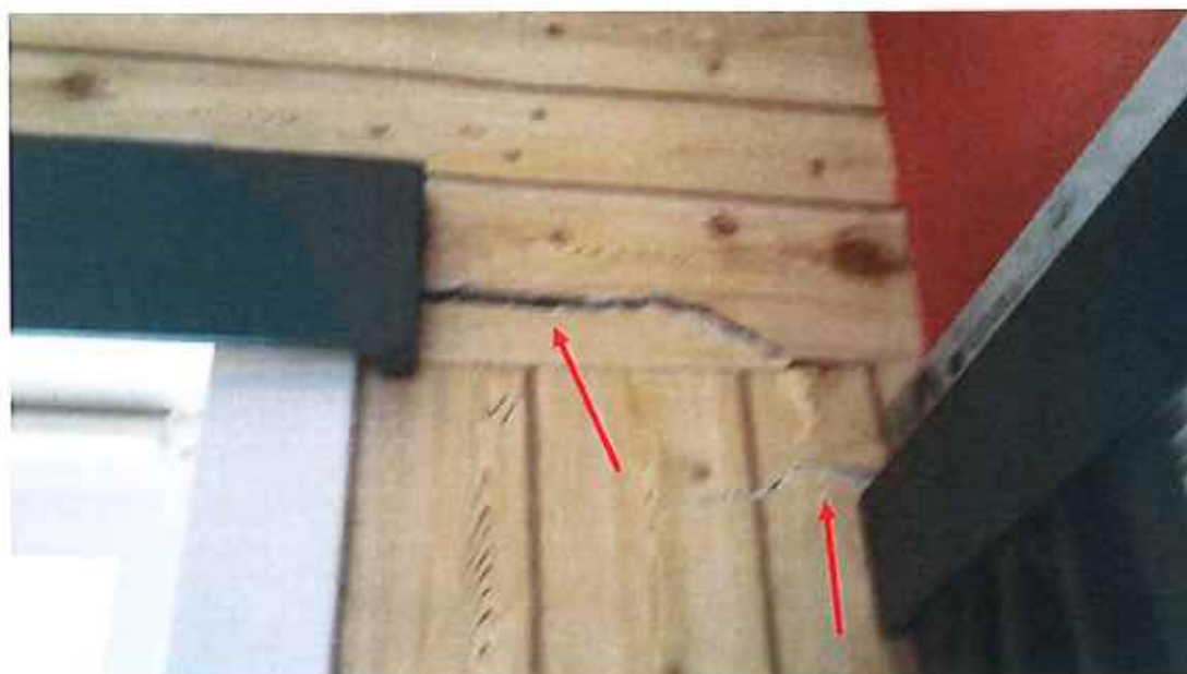
Figuur 30 : Schadebeeld n° 12 : verzakking van achtergevel / vloer, scheurvorming in ruwbouwmetselwerk en binnenpleisterwerk
