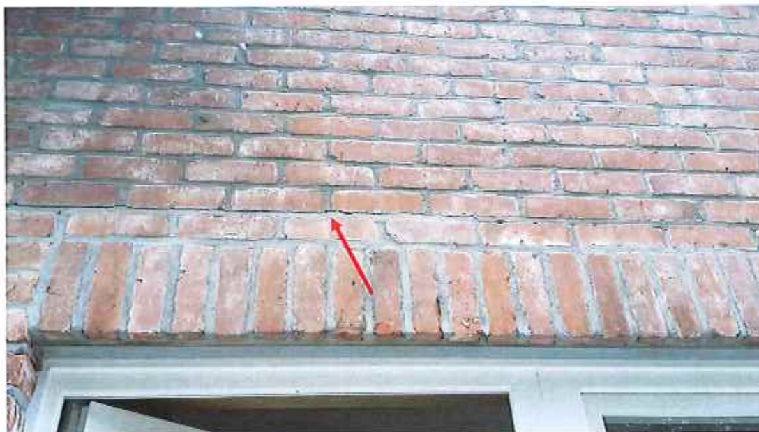
Figuur 5 : Schadebeeld n° 1 : lichte scheurvorming in gevelmetselwerk boven raamopening
