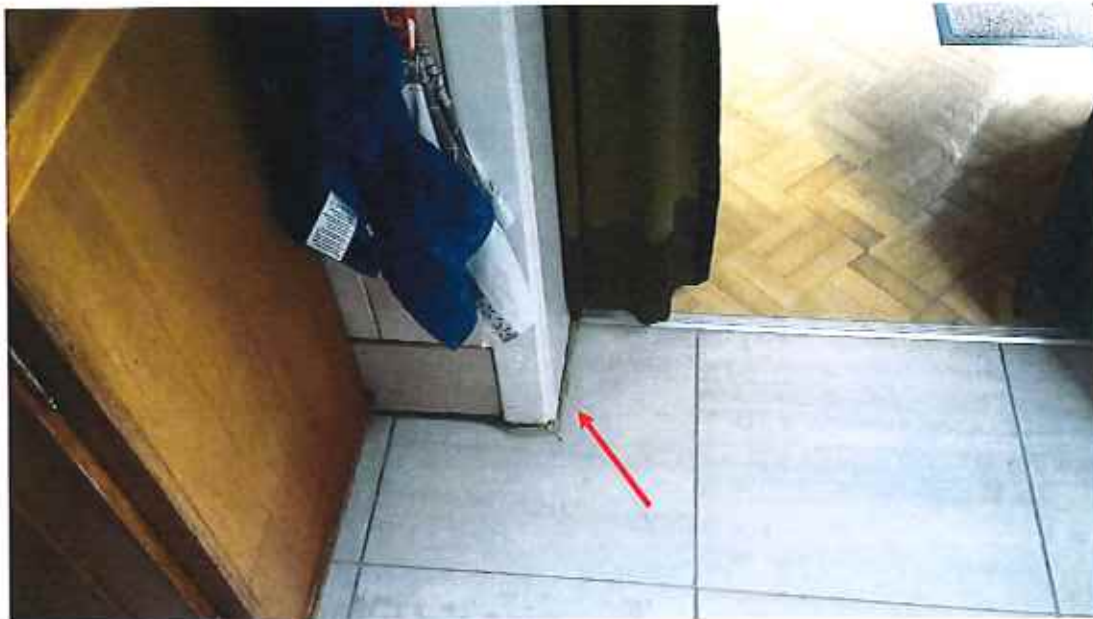
Figuur 25 : Schadebeeld n° 12 : verzakking van achtergevel / vloer, scheurvorming in ruwbouwmetselwerk en binnenpleisterwerk
