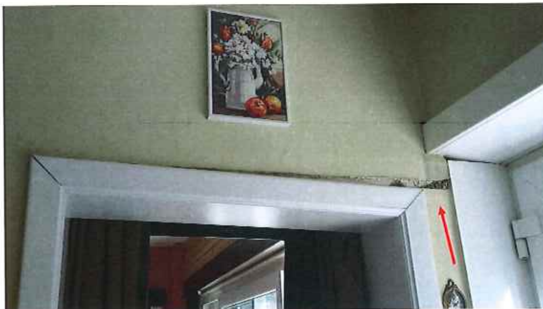
Figuur 26 : Schadebeeld n° 12 : verzakking van achtergevel / vloer, scheurvorming in ruwbouwmetselwerk en binnenpleisterwerk
