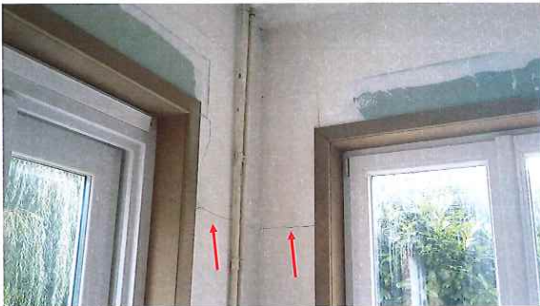
Figuur 19 : Schadebeeld n° 8 : scheurvorming in binnenpleisterwerk
