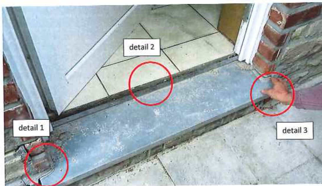
Figuur 6 : Schadebeeld n° 2 : verzakking van deurdorpel
