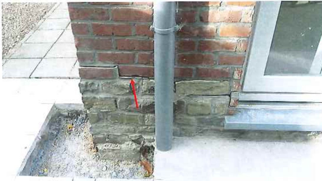
Figuur 17 : Schadebeeld n° 7 : scheurvorming in gevelmetselwerk
