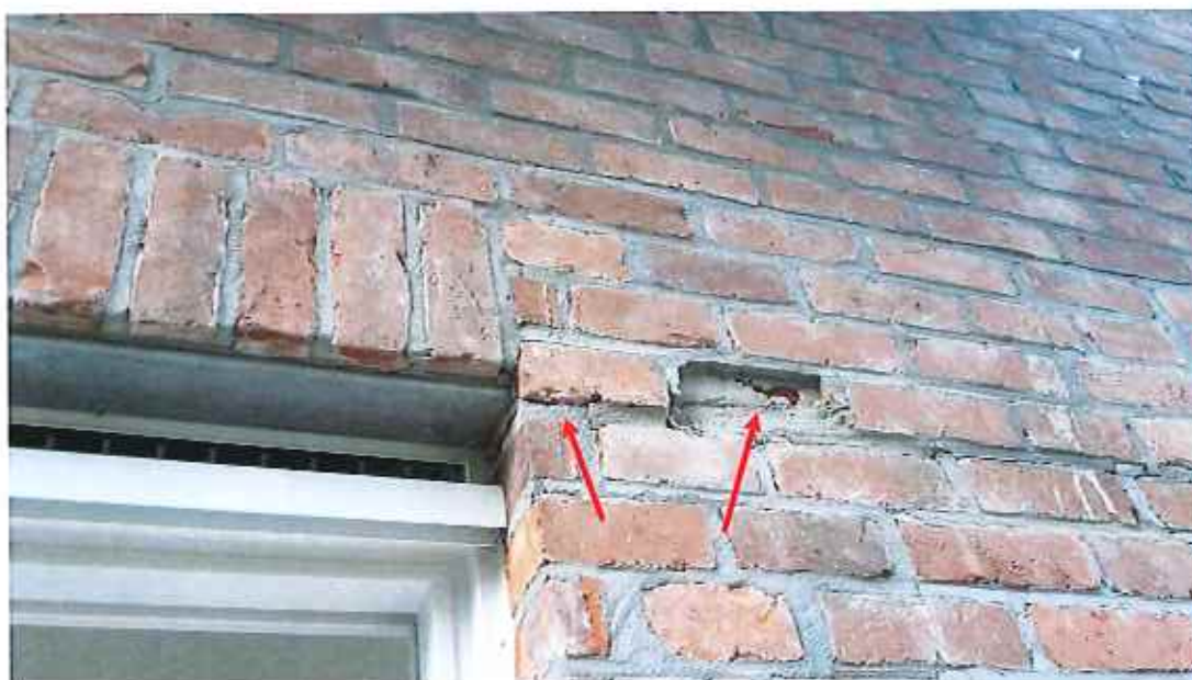
Figuur 13 : Schadebeeld n° 5 : scheurvorming in gevelmetselwerk en afbrokkeling van gevelmetselwerk
