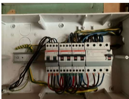
( Elektrisch bord - binnenkant )
