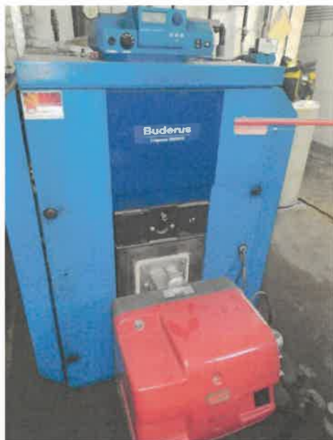
Figuur 5: De ketel is een recent model, geen asbest
