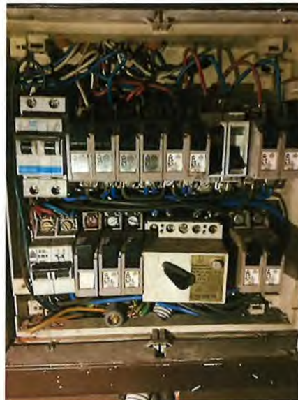
( Elektrisch bord - binnenkant )
