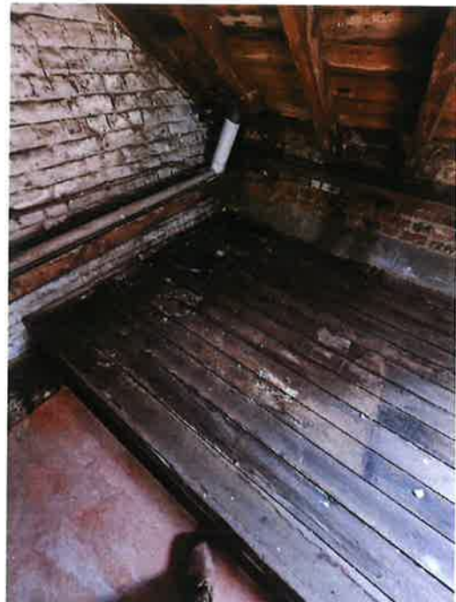
Zone qui a été touchée par l'infiltration
